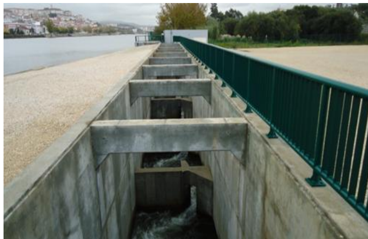
Figura 2 – Vista da passagem para peixes instalada no açude Ponte de Coimbra
